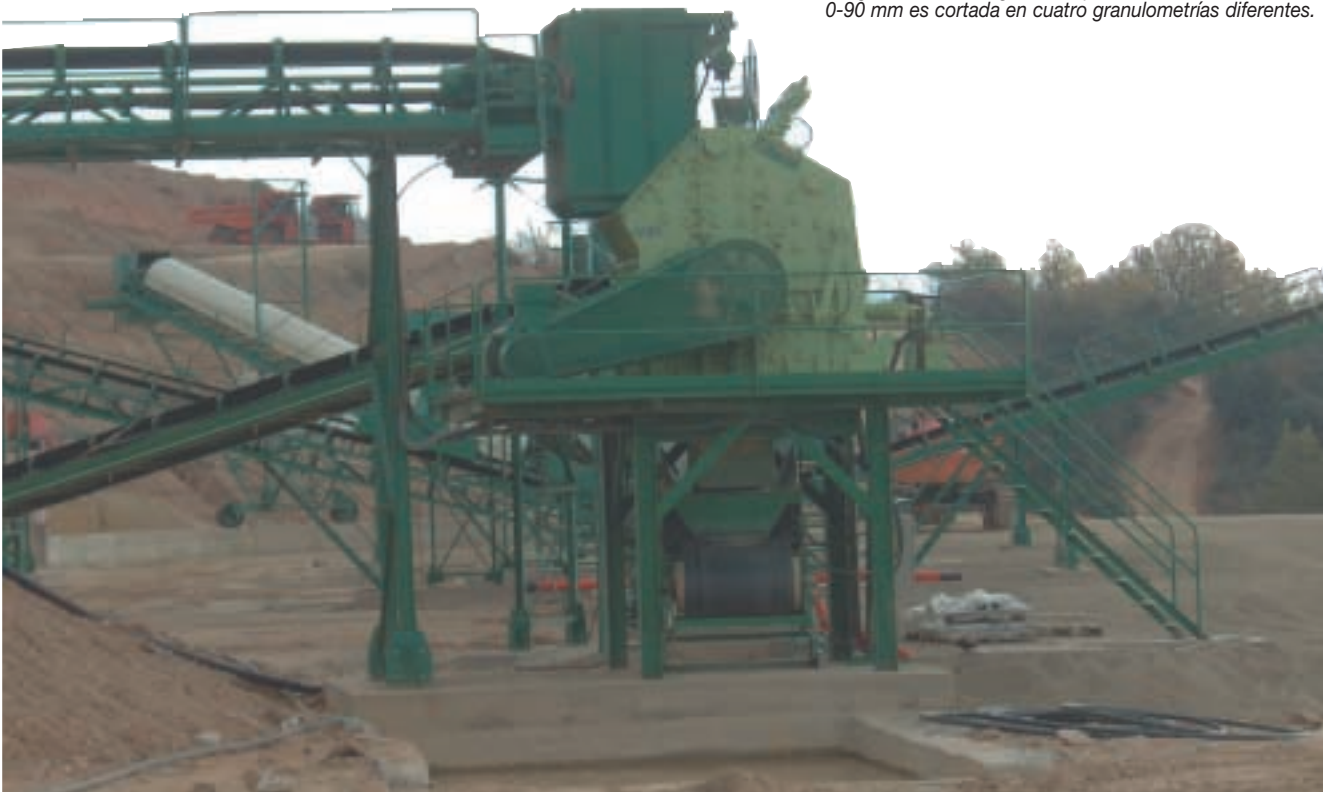
Figura 4.- El Triman IST-6 es el impactor responsable de reducir la granulometría acopiada en el stock de regulación.
